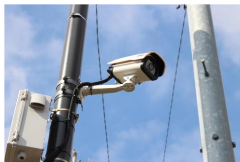
<県補助事業により設置した防犯カメラ>
