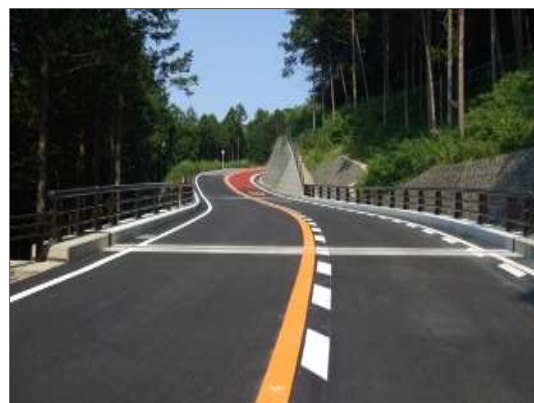
トラックやバス等大型車両の通行も可能となった農道
