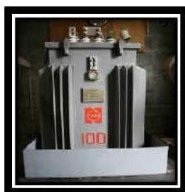
変圧器(トランス)
