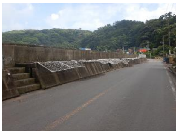
琴ヶ浜周辺の護岸の転落防止柵
